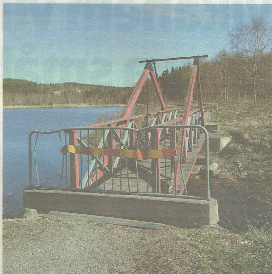
Ledningen för byalaget i Saxdalen förutsätter att gångbron snarast blir reparerad. FOTO: PRIVAT
