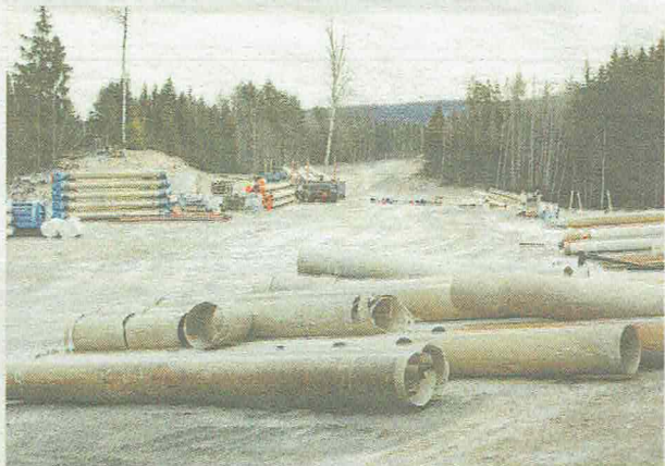
4 januari. Strax före julhelgen 2016 upptäcktes nya läckor på den ökända vattenledningen mellan Östansbo i Ludvika och Spendrups i Grängesberg. Entreprenören NCC meddelade att ledningsarbetet var stoppat tills vidare. FOTO: TORBJÖRN GRANLING
