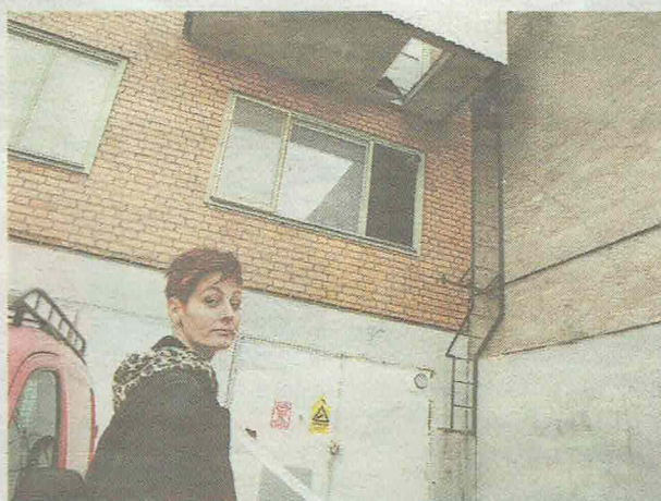
28 SEPTEMBER. En tonårig pojke föll genom golvet till en balkong i centrala Ludvika. Linda-Marie Kollin, tidigare hyresgäst i huset, hävdade att fastigheten i stort är i dåligt skick. "Olyckan var väntad. Den här balkongen har varit dålig i flera år." "Rent skitsnack", replikerade fastighetsägaren. Polisen upprättade anmälan om misstanke om vållande till kroppsskada, men ännu är det oklart om någon kommer att åtalas.
