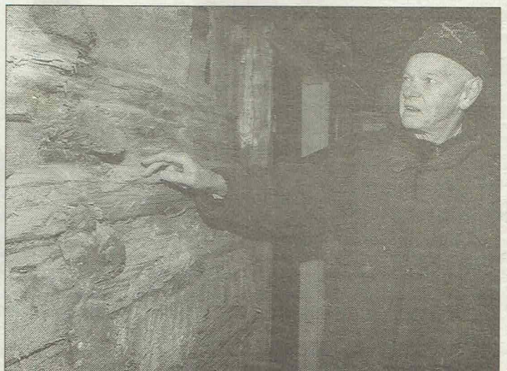
Dåligt timmer. – Många ruttna timmerstockar måste bytas ut, berättar Lars Åhlström.
