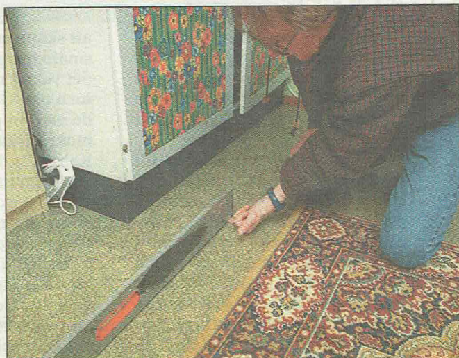
Sanering orsaken? NLT:s reporter fann att ett av husen satt sig, de boende tror att det hänger samman med den omfattande gruvsaneringen i Saxdalen 1991.
