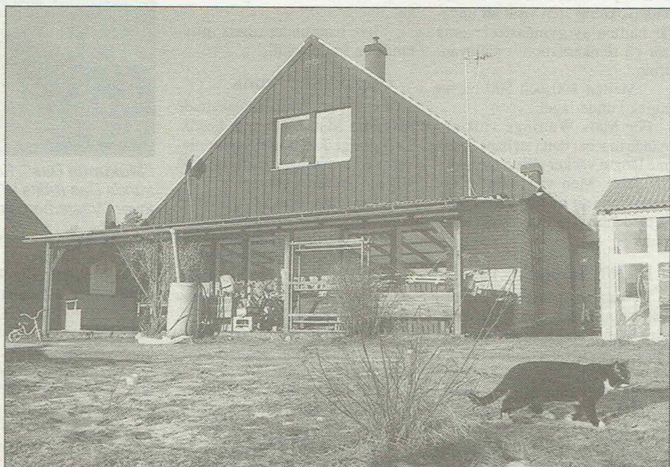
Litet problem. Familjen Åbergs dåligt växande gräsmatta kanske kommer att visa sig vara det minsta problemet, huset satte sig sex centimeter efter entreprenörens framfart
